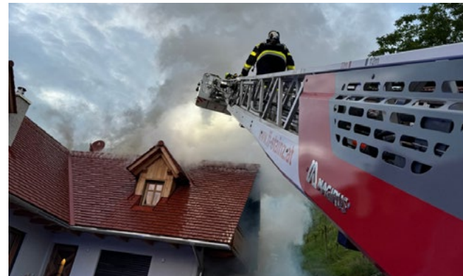
22. Mai 2024: Brand einer Gartensauna in Stainz: Die Flammen hatten bereits auf den Dachstuhl eines zu diesem Zeitpunkt unbewohnten Wohnhauses übergegriffen. Mit mehreren Strahlrohren und mithilfe der Drehleiter Stainz wurde ein umfassender Löschangriff vorgenommen. Im Einsatz: Feuerwehren Stainz, Wald b. Stainz, Ettendorf b. Stainz, Stallhof, Bad Gams, Wildbach (ELF) und Magna Lannach (WLF-ATS).
