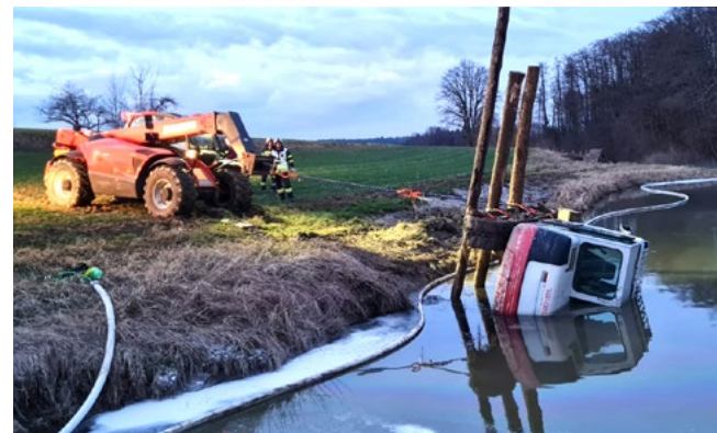
04. März 2024: Ein Baggerfahrer war in Graschuh mit Erdarbeiten in der Nähe eines Teiches beschäftigt, als sein Bagger plötzlich wegrutschte, kippte und in einem Teich seitlich liegen blieb. Im Einsatz: Feuerwehren Rassach, Schamberg und Ettendorf (ÖF).
