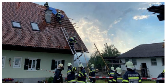
27. Mai 2022: Ein Blitz schlug in der Schambergerstraße in einen Dachstuhl eines Wohnhauses ein, dabei wurde durch die Wucht des Blitzes ein Teil des Daches zerstört. Im Einsatz: 5 Feuerwehren.
