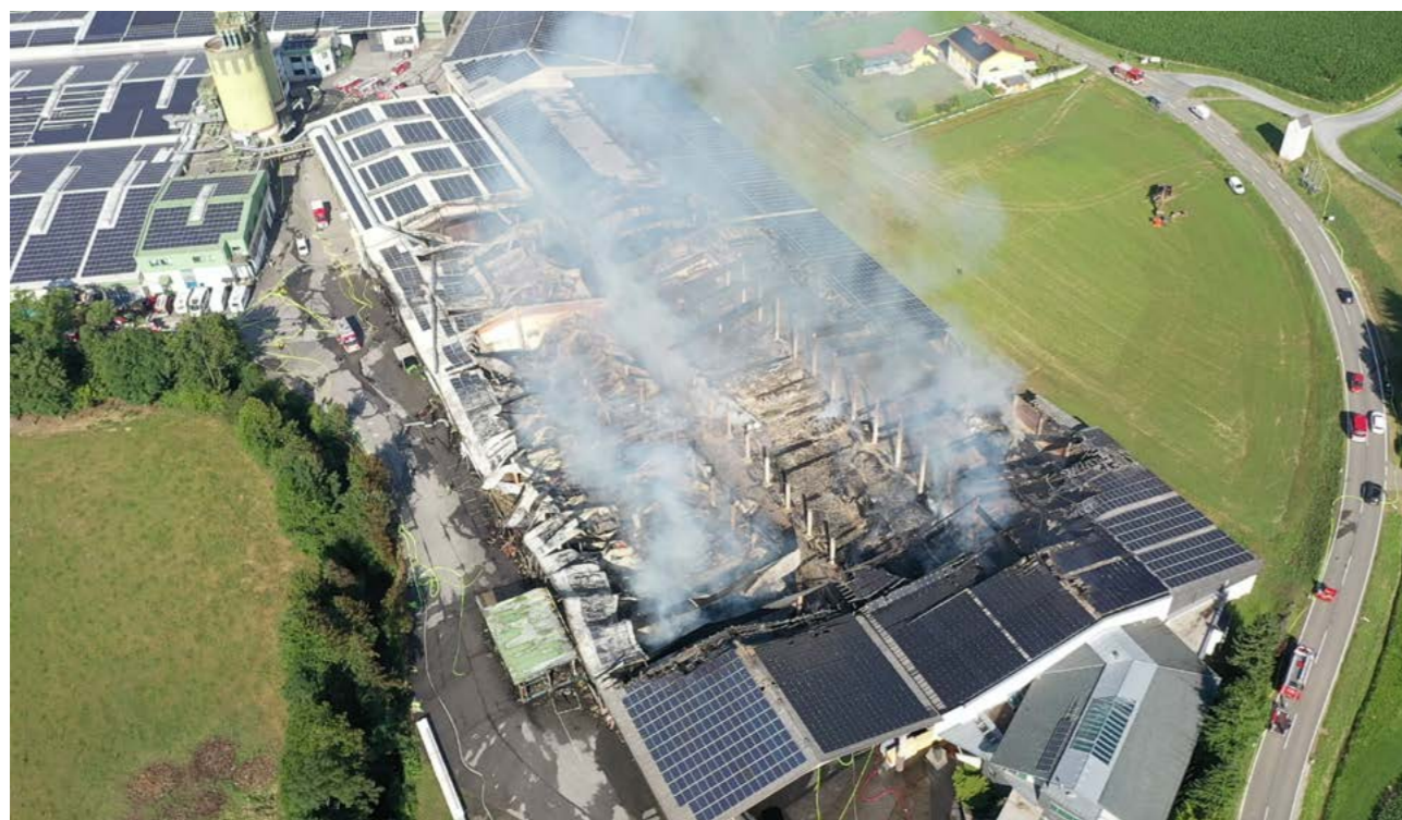
Das wahre Schadensausmaß zeigte sich erst nach Tagesanbruch. Hier in der Luftaufnahme besonders gut zu erkennen, welche Hallen(-teile) ein Raub der Flammen wurden.
