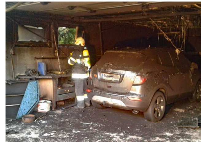
30. August 2020: Eine Garage in Rettenbach hat in der Nacht unbemerkt Feuer gefangen. Das Feuer war wegen Sauerstoffmangels in der Garage von selbst wieder erloschen. Im Einsatz: Feuerwehren Rettenbach und Hollenegg.
