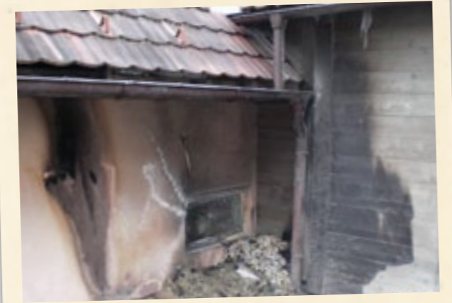
29.01.2015: Wohnhausbrand in Wildbach. Durch rasches Handeln konnte Schlimmeres verhindert werden. Die Feuerwehren Wildbach und Deutschlandsberg waren im Einsatz.
