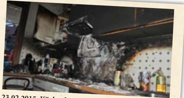
23.02.2015: Küchenbrand in Frauental. Die Feuerwehren Frauental, Freidorf und Schamberg verhinderten höheren Schaden. Zwei Jugendliche wurden ins Krankenhaus gebracht.
