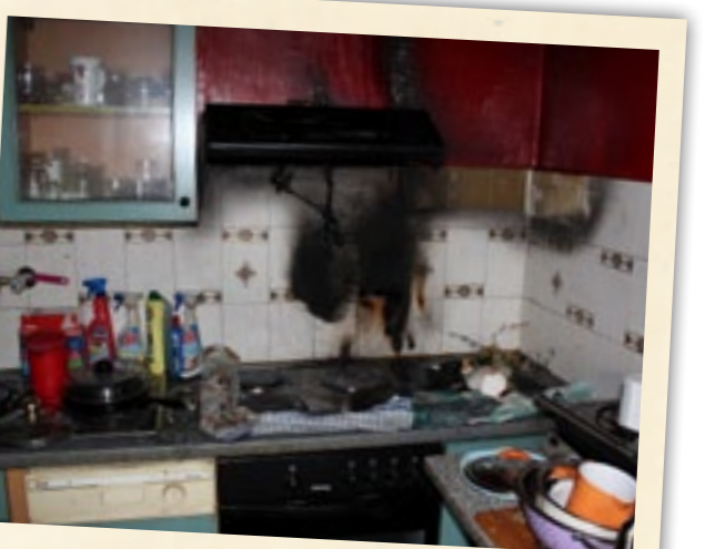
08.07.2015: Zimmerbrand in einer Wohnhaussiedlung in Eibiswald. Im Einsatz standen die Feuerwehren Eibiswald, Hörmsdorf und Pitschgau-Haselbach. Zwei Hausbewohner wurden ins Krankenhaus gebracht.
