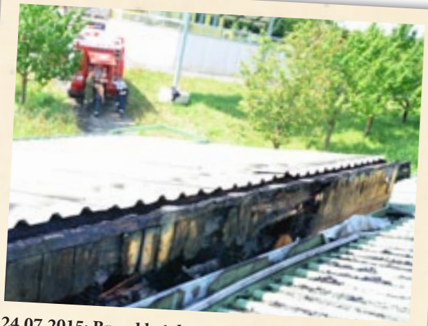
24.07.2015: Brand bei der Festhalle Rassach. Sieben Feuerwehren mussten auch einen angrenzenden Gastank kühlen.
