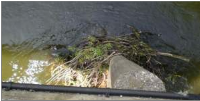
Lage Fußgängersteig und Rohrbrücke: Instabiles Fundament
