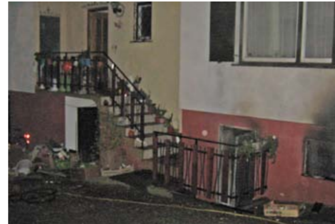
Heizraumbrand in Tobisegg am 02.11.2010, im Einsatz: FF Oisnitz, FF St. Josef & FF Zwaring (LB)
