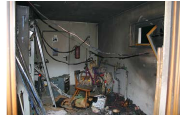
Brand in einem Abstellraum in Pölfing-Brunn am 25.11.2010, im Einsatz: FF Pölfing-Brunn, FF Wies & FF St. Ulrich
